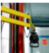
LUZ LED PARA ZONA DE CARGA
