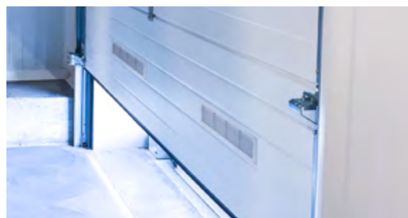
REJILLA DE VENTILACIÓN
